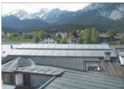
28 keräintä asennettu hotellin katolle
