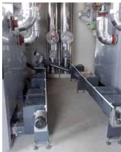
Tässä kuvassa näkyy kahden kaskadikäytössä olevan HERZ kattilan tuhkalätköt, joita yhdistää toisiinsa tuhkan siirtoruuvi.
