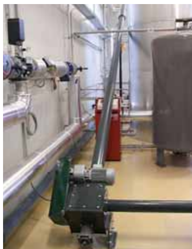
Esimerkiksi tämä nousuruuvi siirtää tuhkan kahdelta HERZ kattilalta n. 4 m:n korkeudessa kattilahuoneen ulkopuolella olevaan 2 m 3 :n tuhkasäiliöön.
